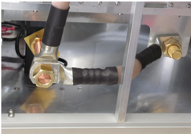
Abb. 6. Sicht auf die Kurzschlussbrücke „BNB 8656 L1/L2 short“ in „HV+“ Pfad. Fig. 6. View of the shorting bridge "BNB 8656 L1/L2 short" in "HV+" path.
